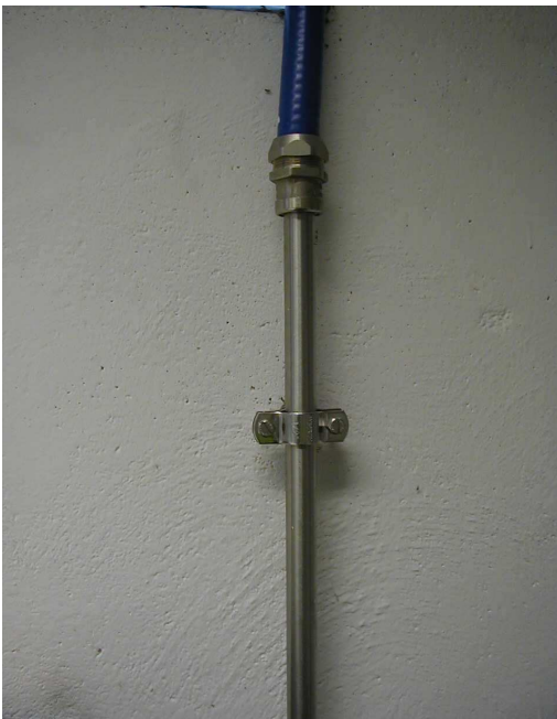
Foto 1 - Esempio di tubo in acciaio inox e guaina metallica rivestita in PVC
