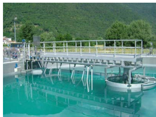
carroponte di sedimentazione con collettore a spazzole e quadro a bordo macchina
