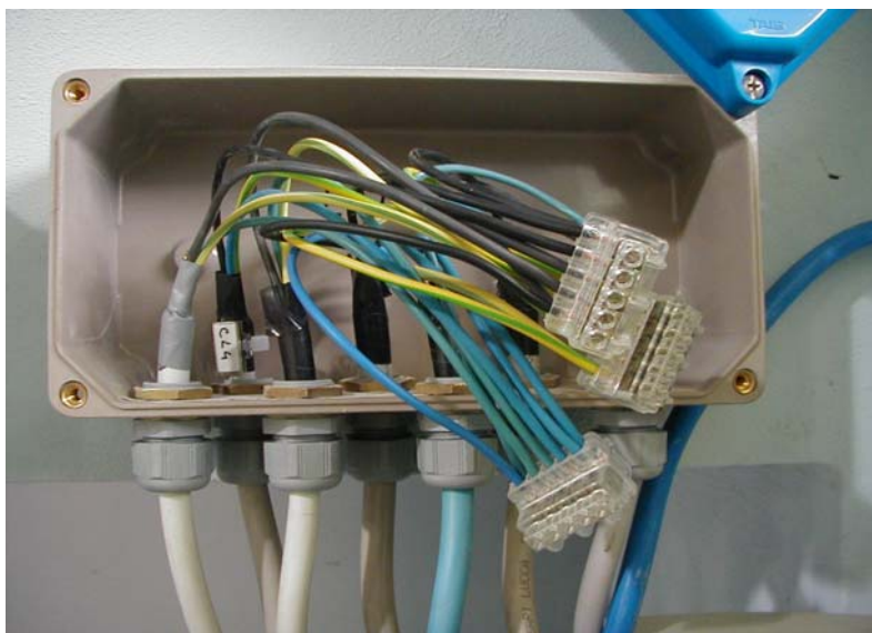
Foto 3 - Esempio di morsetti multipli da utilizzare per le derivazioni soprattutto nei circuiti luce e prese.
