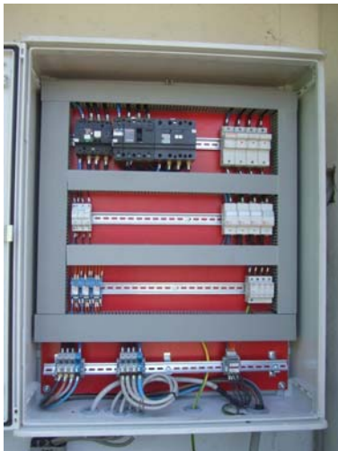
quadro interruttore generale per consegna BT con pannello di fondo in materiale isolante
