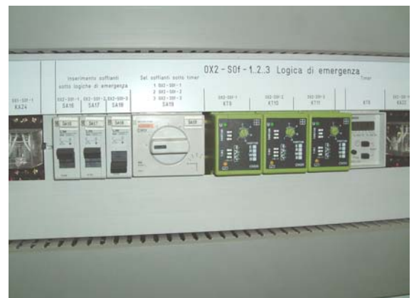
targhe descrittive a servizio delle logiche di emergenza elettromeccaniche
